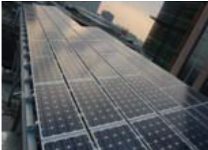
中国深圳 Shenzhen, China, 10KWp 大楼平台固定, 与市电互补示范 Roof-Mounted & Grid-Tied 2009 年 06 月建成 Completion Year in June,2009
