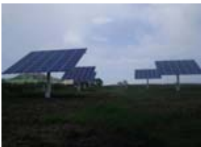
意大利 Italy, 99.36KWp 市电并网, 使用自动追踪系统 Grid-Tied,with solar tracking system 2011 年 04 月建成 Completion Year: April,2011
