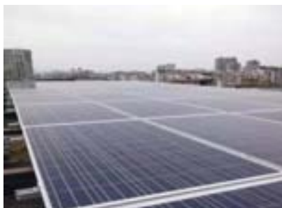
上海 Shanghai, 20KWp 大楼平台固定, 与市电互补示范 Roof-Mounted & Grid-Tied 2012 年 06 月建成 Completion Year: June, 2012
