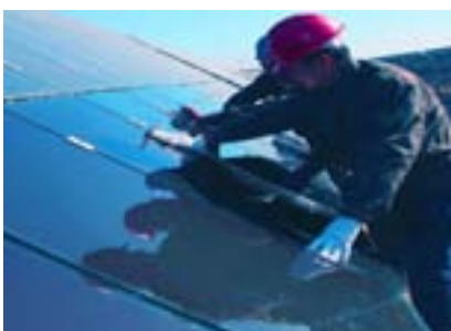
青海,海南 Hainan, Qinghai, 20MWp 市电并网, 使用薄膜太阳能组件 Grid-Tied, with Thin Film Solar Panels 2014 年 04 月建成 Completion Year: April, 2014
